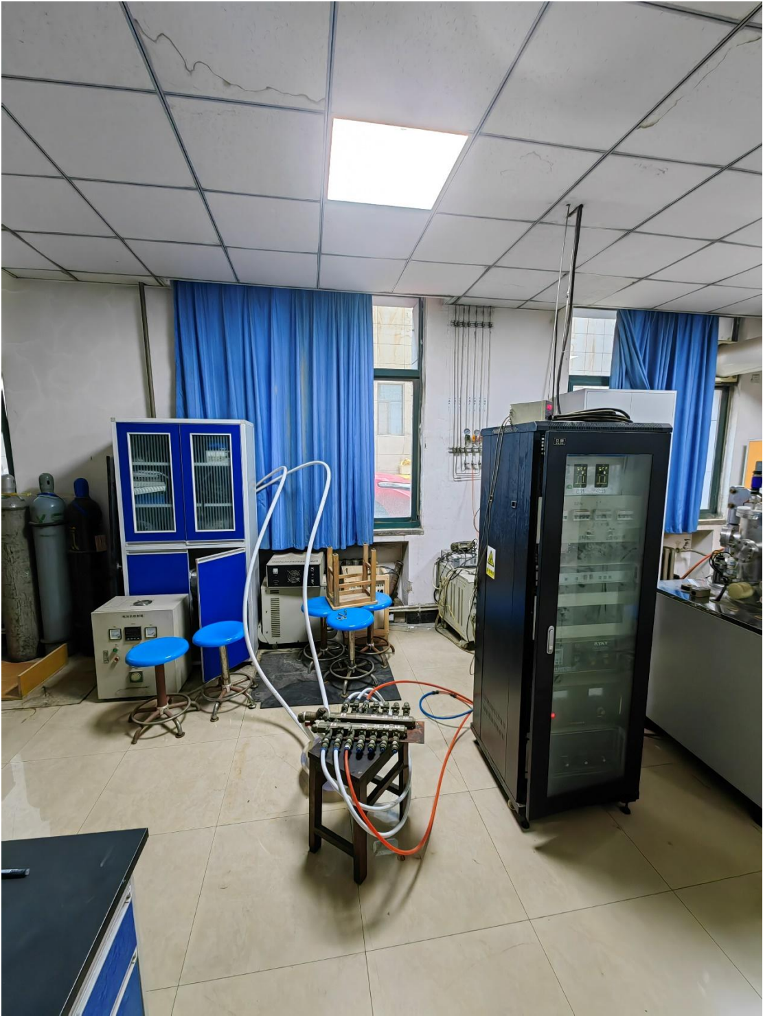
格致楼 1033 房间：冷却水临时随意连接
