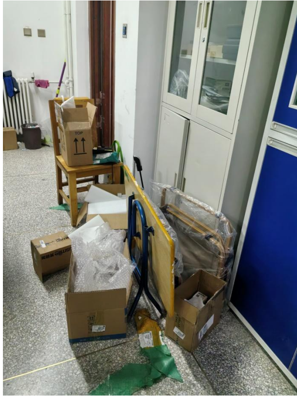
理工楼 122-123 房间：乱堆杂物，电源柜门被挡
