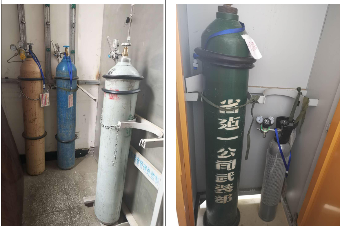
图 4. 格致楼 3035, 已整改。氧气瓶与氢气、硼烷已分开存放, 氢气（已标明待报废）、硼烷存放在格致楼 3037 实验室。
