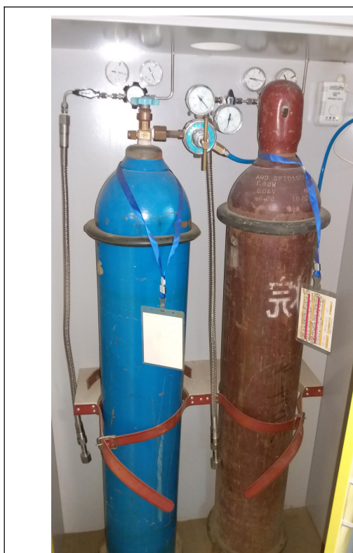
图1. 格致楼 2043-1，氧气瓶和甲烷共储存在一个气瓶柜内。存在较大安全隐患，须立即整改。
