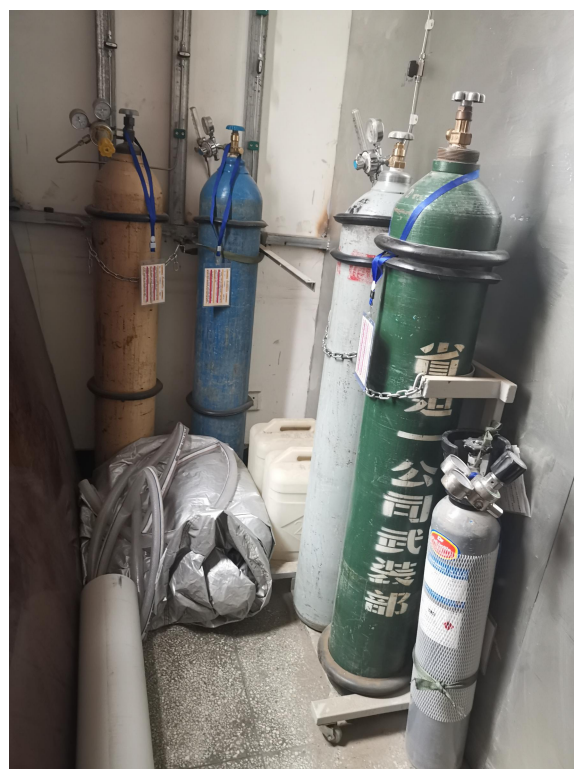
图2. 格致楼 3035，氧气瓶和氢气、硼烷共存放在一个小气瓶间；紧邻气瓶堆放杂物、有机废液桶。存在较大安全隐患，须立即整改。
